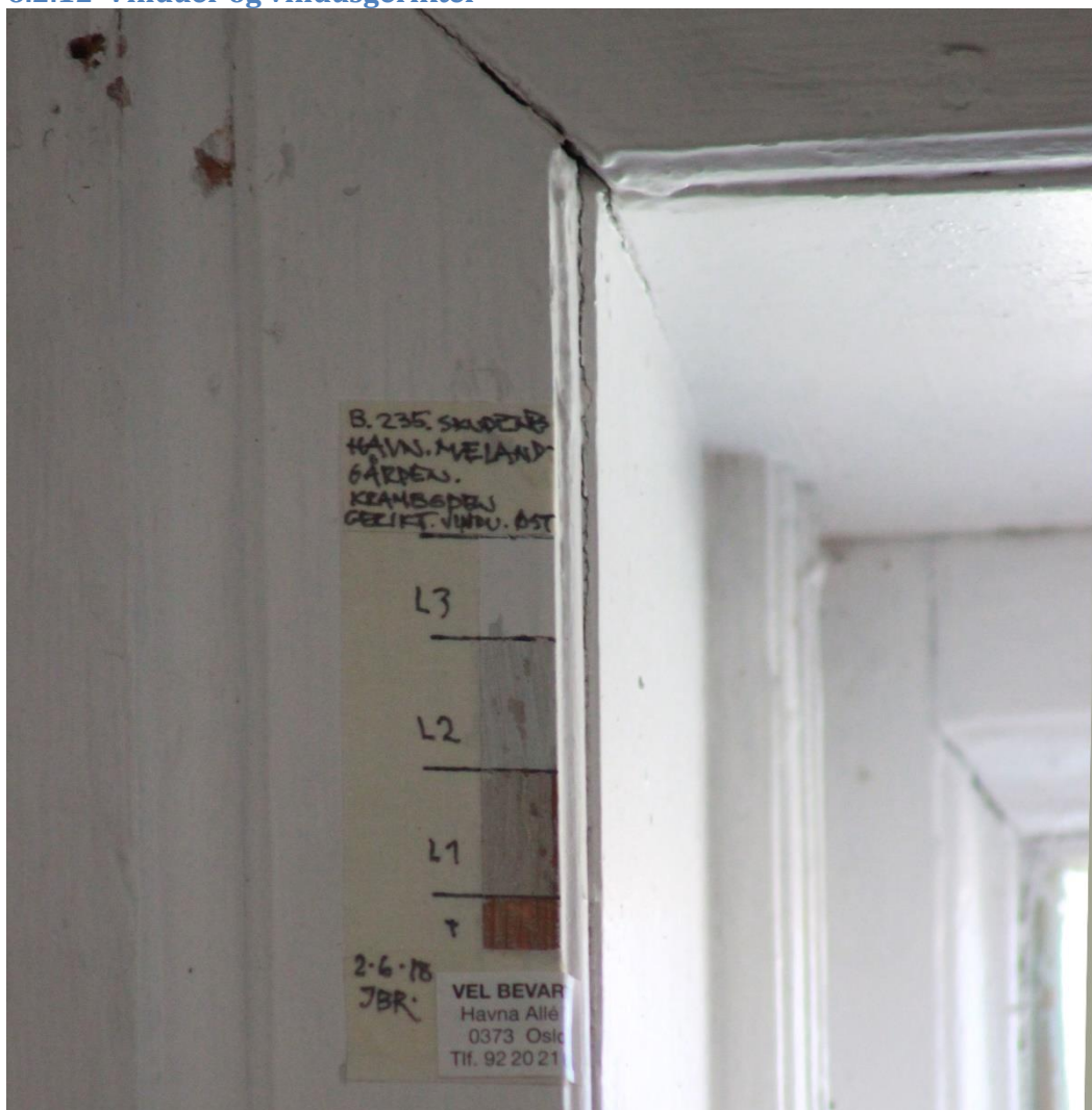
Figur 129. Skudeneshavn. Holmen 16. Kramboden. Fargelagsavdekking på vindusgerikten. Foto: J. Brønne. Juni 2018.
