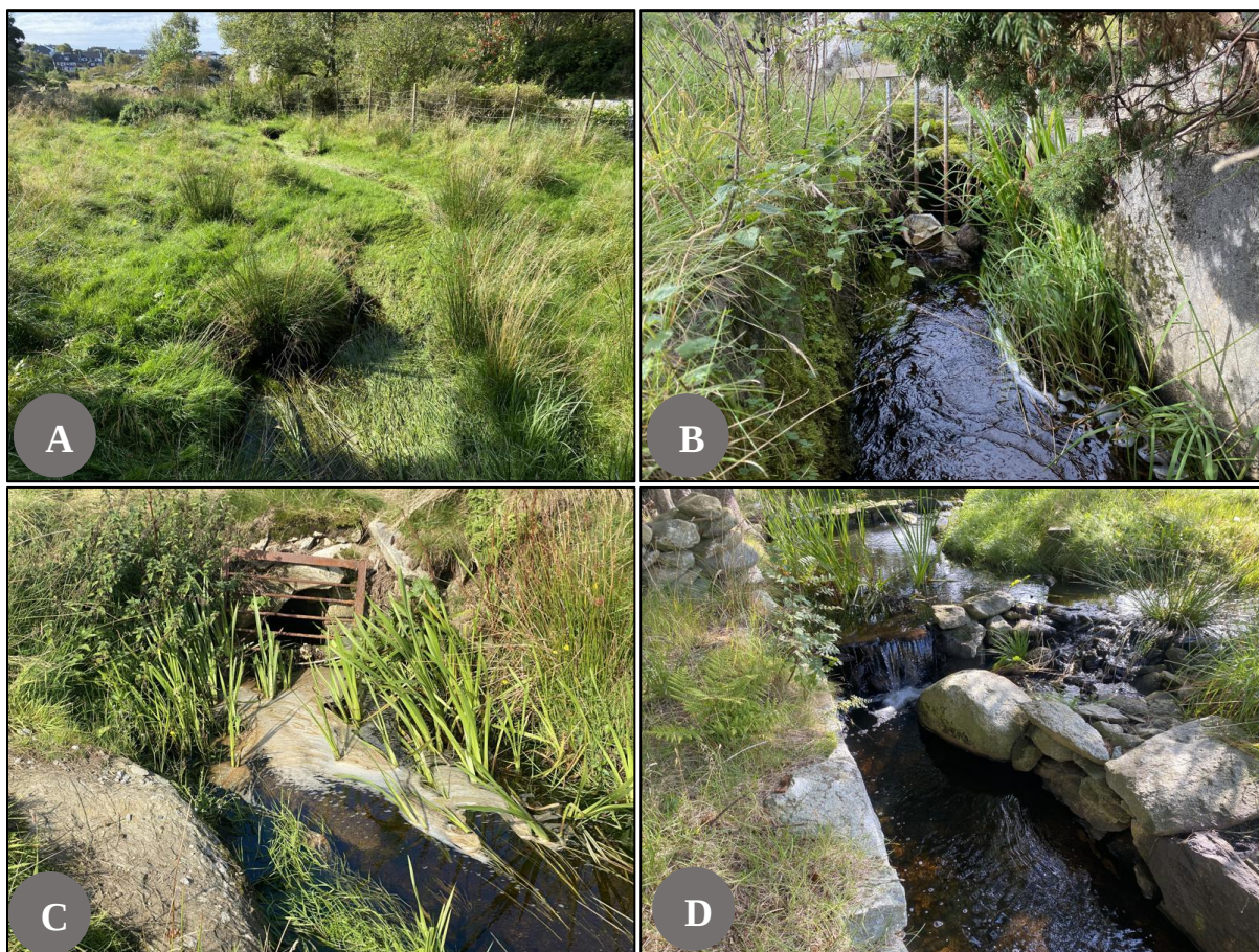
Figur 60. Vandringshindre i Varnebekken. A) I segment 5 er det mye gress i bekken før den forsvinner under bakken. Det er uvisst om bekken renner gjennom rør eller en steinkulvert. Det er spor av overløp på gresset hvor vannet renner på høy vannføring. B) Øvre inngang til lang bekkelukking mellom segment 7 og 8 er blokkert av et jerngitter med vertikale spiler som samler opp avfall og kan hindre passasje for fisk. C) Øvre inngang til kort bekkelukking i nedre del av segment 8 er blokkert av et jerngitter med horisontale spiler som kan hindre passasje, også for større fisk. D) En kunstig terskel i segment 11 som utgjør et temporært vandringshinder for ungfisk, men god satskulp gjør det lett for gytefisk å passere.
