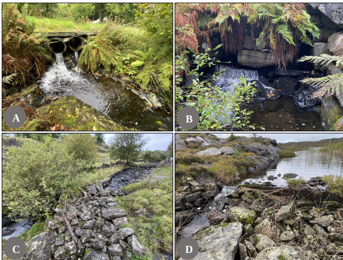
Figur 27. Kunstige vandringshindre og bekkelukkinger i Labergbekken. A) Kunstig og krevende temporært vandringshinder i form av en bekkelukking under en traktorbro i segment 4. Rørene er 60 cm over vannoverflaten og kulpen er 40 cm dyp. B) Bekkelukking nummer tre nedenfra går under en traktorvei i segment 9 og utgjør et absolutt vandringshinder for anadrom fisk. Det er en trang steinkulvert som klogger bekkeløpet ved å samle opp kvist og grener. C) Kunstig absolutt vandringshinder i segment 9. D) Kunstig temporært vandringshinder i utløpet fra Stemmen. Vannet er demmet opp med et lite overløp på ene siden.
