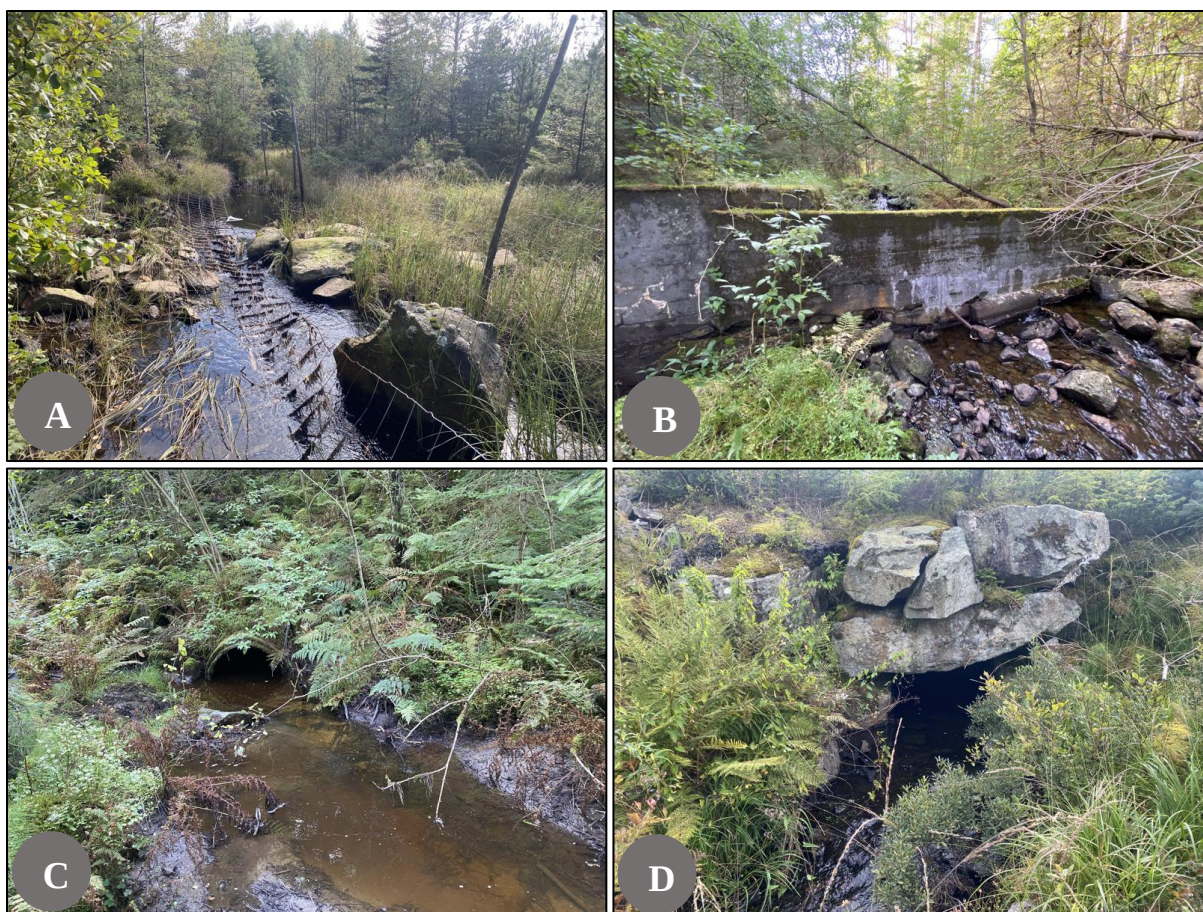
Figur 67. Kunstige vandringshindre og bekkelukkinger i utløpsbekkene fra Grodvatnet og Visnesvatnet. A) Gammelt gjerde som ligger i bekken i segment 3 og strekker seg ca. 7-8 m i bekkeløpet. B) Betongmur som går tvers over bekken i segment 7. Det er mulig å passere muren på høyre side ved rett vannføring. C) Utløpet til bekkelukking i nedstrøms del av røret, øverst i segment 8. Et langt steinrør som går under E134. D) Murt bekkelukking i segment 16 på sju m med ok passasje for fisk, og derfor ikke til hinder for fisken.
