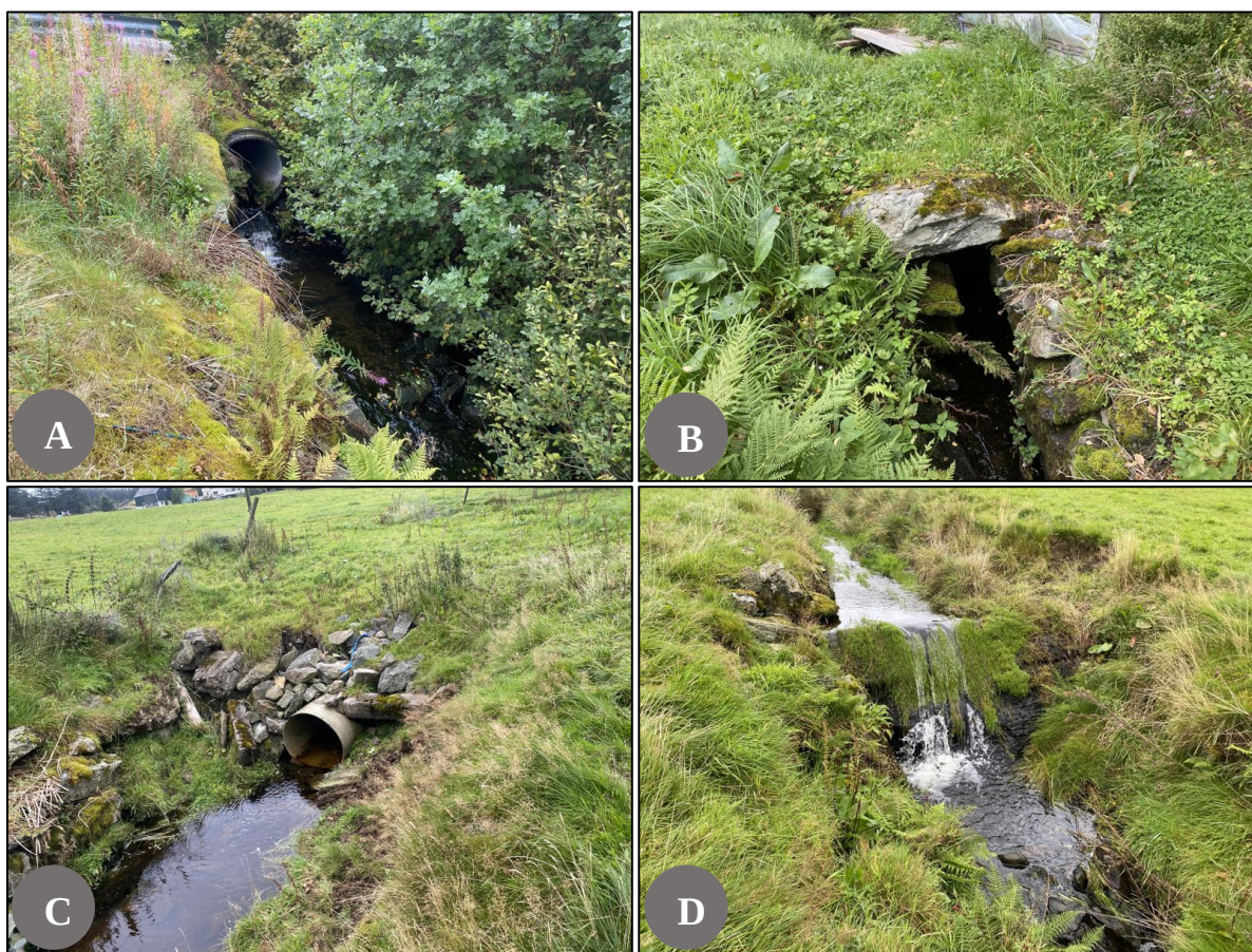
Figur 46. Vandringshindre og bekkelukkinger i Sunnaråbekken. A) Bekkelukking mellom segment 1 og 2 i form av et stort betongrør som går under en bilvei. B) Bekkelukking i form av en bro i segment 3. C) Bekkelukking mellom segment 11 og 12. Her går bekken i rør i 150 m. D) Naturlig absolutt vandringshinder i form av en 2 m høy bergkant. For lite vann renner over til at det er mulig å passere.
