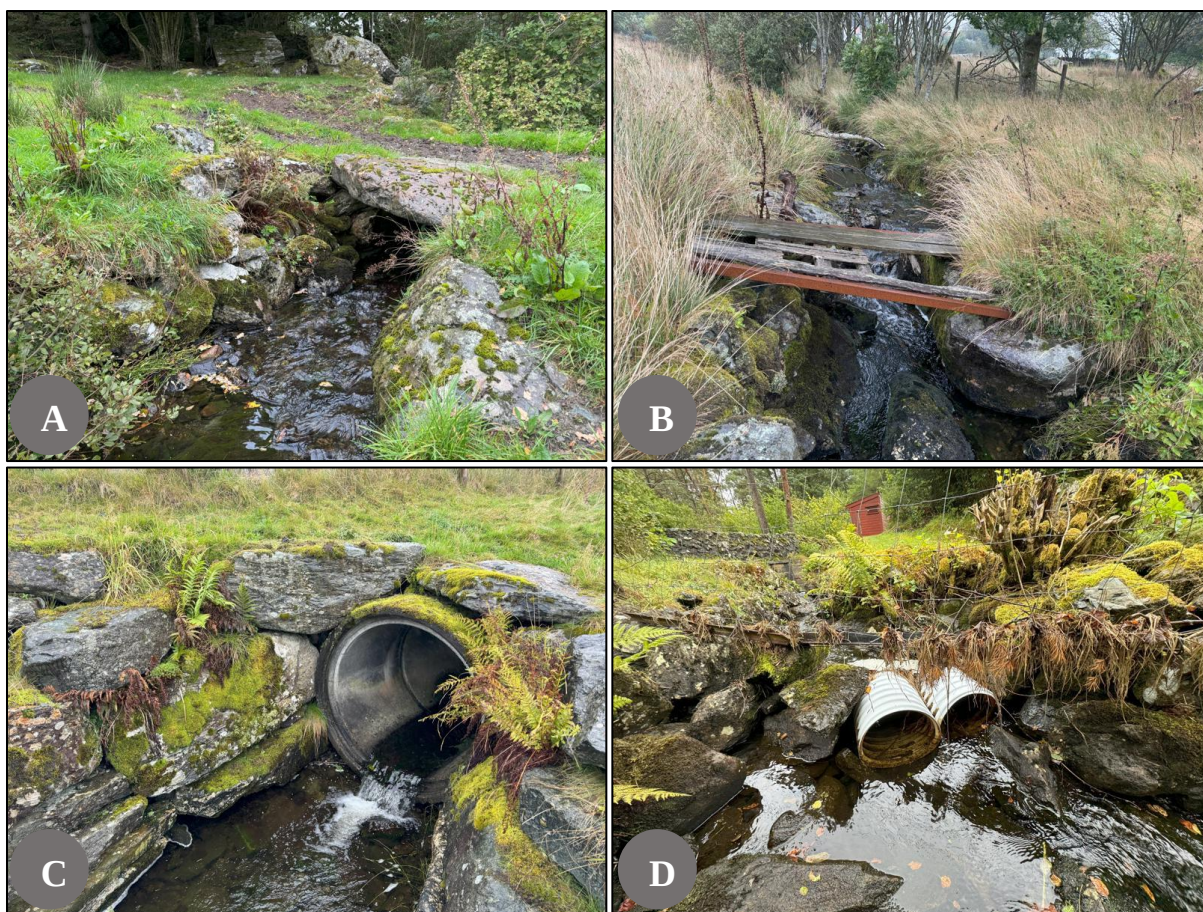
Figur 39. Bekkelukkinger og broer i Stokkastrandbekken. A) Bekkelukking i form av en traktorbro i segment 2. B) Broa i segment 3 er en gammel og sliten bro som ikke regnes som et vandringshinder eller bekkelukking. C) Bekkelukking under hovedveien. Kan være utfordrende å vandre gjennom ved lav vannføring. D) Bekkelukking i form av to korte plastrør i segment 12.
