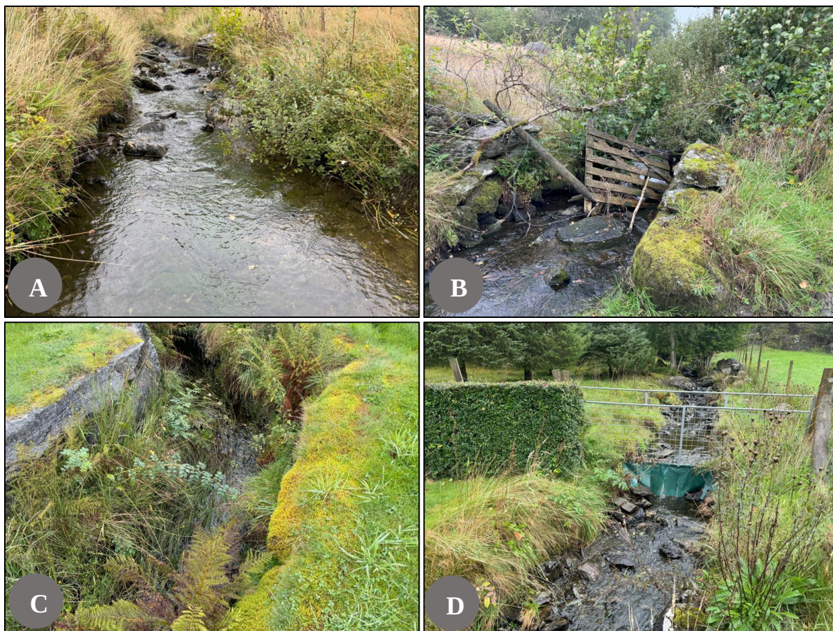
Figur 40. Habitatforhold og morfologiske inngrep i Stokkastrandbekken. A) Segment 2 har mye eutrof begroing. B) Flere plasser i bekken ligger det gamle gjerder som kan være til hinder for fisk ved visse vannføringer. Her et eksempel fra segment 2. C) I segment 7 er det mye planter i bekken. D) Ovenfor segment 11 er bankene til bekken naturlige og ikke lenger forbygde. I toppen av segment 11 er det en grind over bekken med plastremser ned i bekken. Fisk kan vegre seg noe for disse, men det regnes ikke som et vandringshinder.
